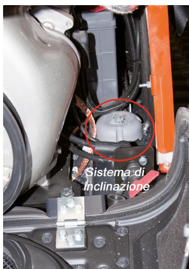
Micro interruttore sul sollevamento della benna
